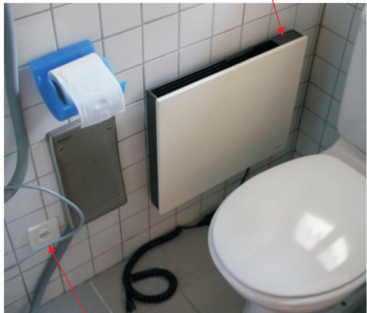
Steckdose für Heizkörper oder Waschmaschine
